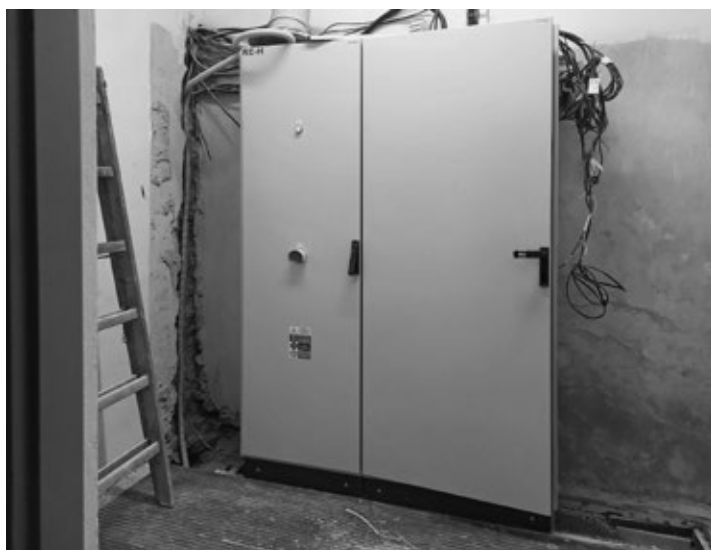
Nová rozvodná skříň v budově mateřinky.
